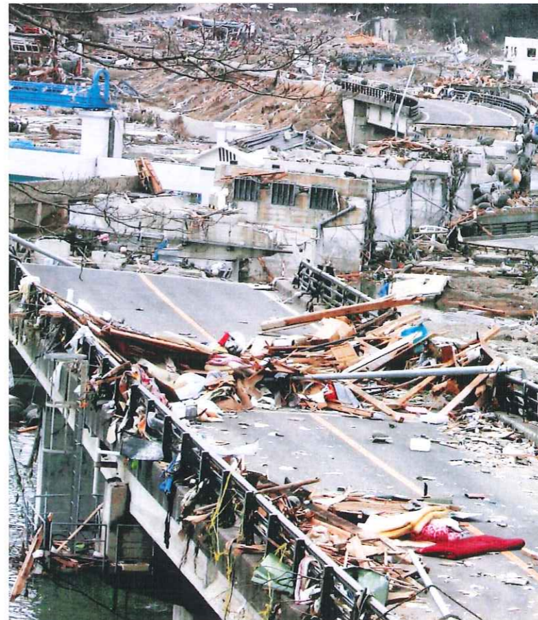
「大津波で流された国道45号の歌津大橋」宮城・南三陸町歌津（河北新報社提供）
